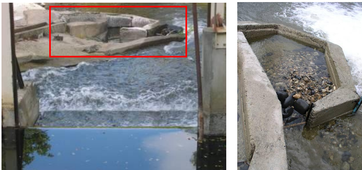
Figure 125 : Configuration de la partie aval de la passe à poisson du barrage de Moulin Grand observée le 5/10/ 2009 (débit journalier Joursac 1 m 3 /s). A Droite bassin aval totalement colmaté (Source : LOGRAMI)
