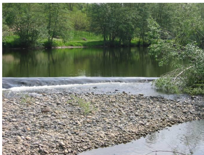
Figure 62 : Barrage et usine de Chilhac le 11-05-2009, débit Langeac 23,9 m 3 /s. En haut à gauche, barrage rive droite et usine. En haut à droite, milieu du barrage. En bas, barrage rive droite. (Sources : LOGRAMI et Banque Hydro)
