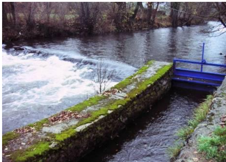
Figure 132 : Barrage et prise d'eau de Courcelles le 9-11-2009 (débit journalier Joursac 6,1 m 3 /s) (Source : LOGRAMI)
