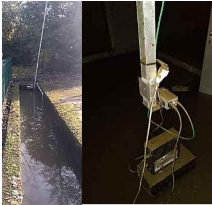
Figure 102 : Inondation du local de vidéo-comptage situé au niveau de l'usine hydroélectrique de Langeac le 29 novembre 2019 avec photographie de l'accès au local entièrement inondé et matériel submergé dans le local constaté après la vidange du local (Source LOGRAMI)
