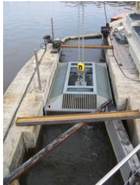
Figure 55 : Cage-piège en place à la sortie de la passe à poissons située en rive droite du pont barrage de Vichy sur l'Allier
